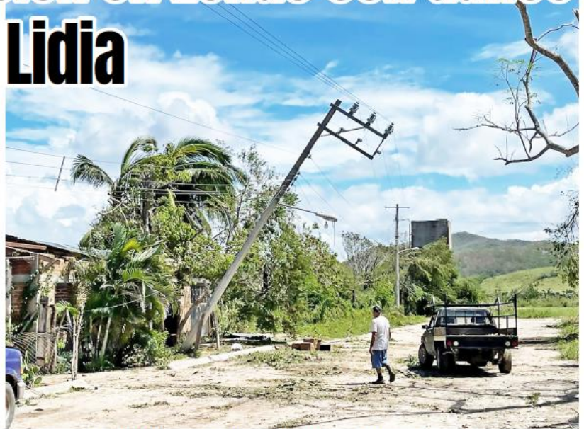
Se trabaja en el restablecimiento de servicios de luz eléctrica en las zonas afectadas.
