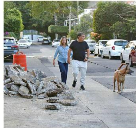
Peatones deben esquivar escombros y arena.
