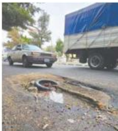
GDL. El hoyanco se ubica en La Calzada casi al cruce con la calle Batallón de San Patricio.
