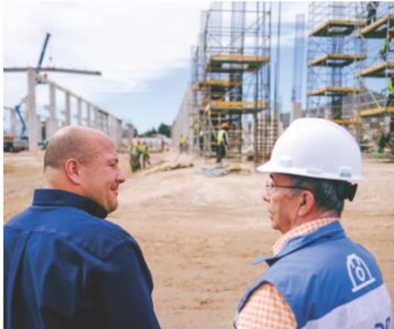
El fin de semana llegaron a Tlajomulco los rieles por donde pasará el tren.
