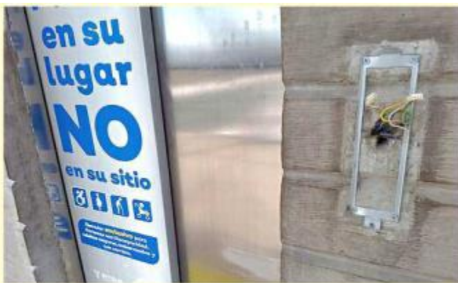
■ Tras un recorrido realizado por este sistema se constató que algunos elevadores presentan fallas.
