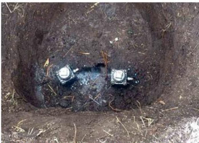
HALLAZGO. Elementos de Sedena localizaron dos tomas clandestinas en el kilómetro 128+366, del poliducto Salamanca-GDL, en Degollado, donde aseguraron 900 litros de hidrocarburo.
