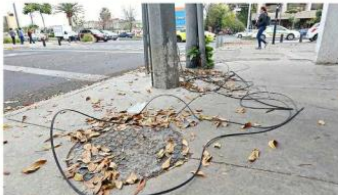
La infraestructura obsoleta es un riesgo para ciudadanos.
