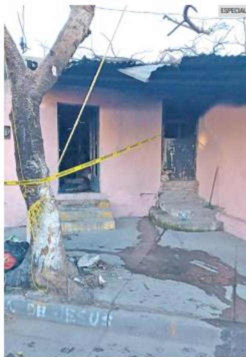
EMERGENCIA. Esta es la finca donde se reportó el incendio, en la Colonia San Pedrito.
