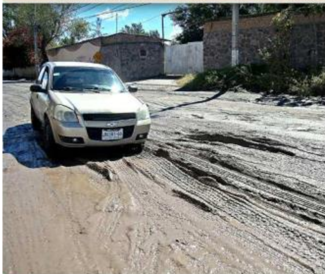
■ Con la lluvia las vialidades quedaron con tierra y baches que hacen ineficiente la circulación.
