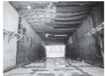
Los colectores forman parte de una red.
