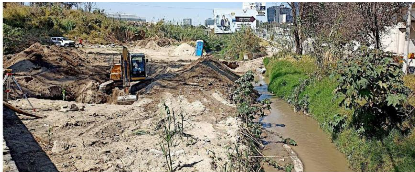
Los trabajos comenzaron hace unos días, pero continúan las fugas de aguas negras al canal contiguo.
