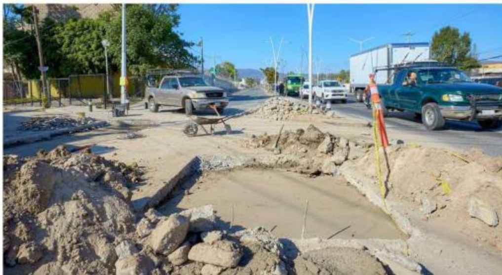
La obra se debe a una fuga de agua, misma que atiende el Siapa.
