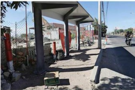
Hay pendientes como colocación de banqueta.
