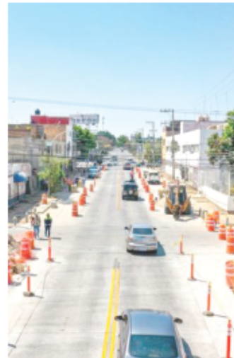
La rehabilitación de esta avenida se realizó a lo largo de 4 kilómetros.
