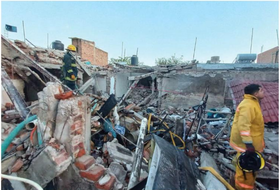
Autoridades realizaron la revisión de la zona para descartar la presencia de más víctimas entre los escombros. ESPECIAL
