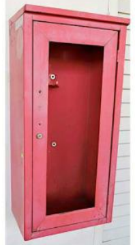
También carecen de extintores.
