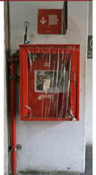
La falta de mangueras para incendios persiste.
