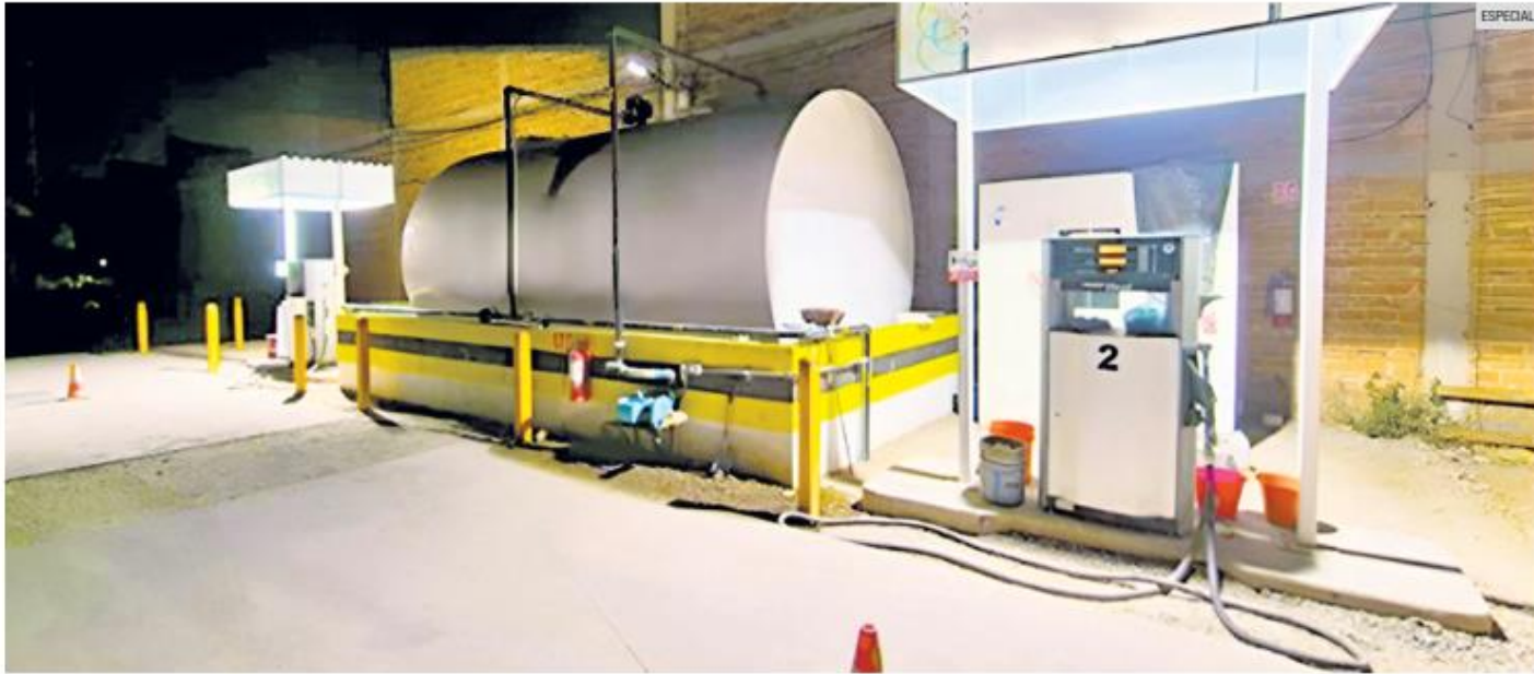
DECOMISO. La gasolinera ilegal operaba en Patria y su cruce con Lázaro Cárdenas dentro de un inmueble que fue cateado por autoridades federales.
