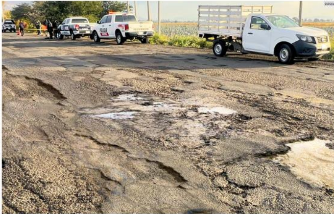
CARRETERA LA BARCA-ATOTONILCO. Debido a la falta de presupuesto federal para el mantenimiento de las carreteras en Jalisco, el 80% están en condiciones inadecuadas, lamenta la Cámara Mexicana de la Industria de la Construcción. Hay riesgo de accidentes en varias regiones.
