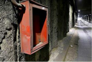
Los túneles de la Avenida López Mateos abajo del Nudo Colón (foto), de la Calzada Lázaro Cárdenas y de la Minerva están sin extintores.
