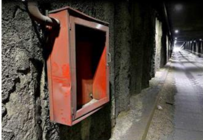
■ Los túneles de la Avenida López Mateos abajo del Nudo Colón (foto), de la Calzada Lázaro Cárdenas y de la Minerva están sin extintores.
