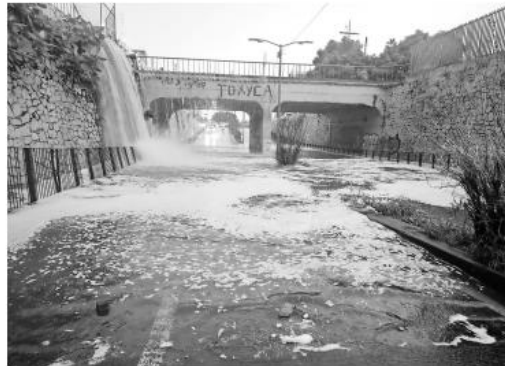
Pasos a desnivel de riesgo para automovilistas.
