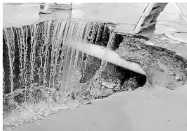
¿Cascada?, no, es un socavón. PABLO TOLEDO
