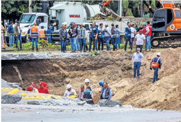
ARROYO SECO. El agua desembocó de manera subterránea en la Avenida López Mateos y devoró el asfalto, generando el hundimiento.
