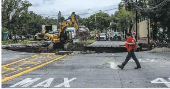
LOPEZ MATEOS. El socavón tiene una extensión de 12 metros de ancho, por 40 de largo y 4 metros de profundidad.
