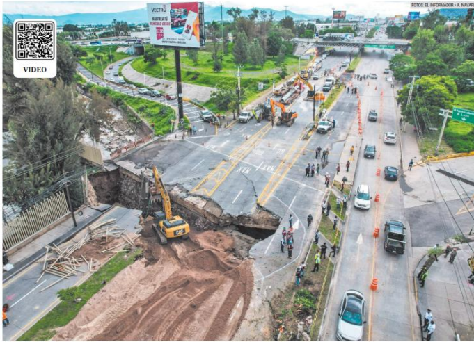
INCIDENTO. El hundimiento de López Mateos es de los más grandes registrados en la ciudad, afectando a una de las avenidas más importantes.
