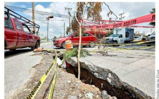
■ SIAPA indicó que hoy dará detalles sobre el socavón de Prolongación Avenida Mariano Otero y Tepeyac.
