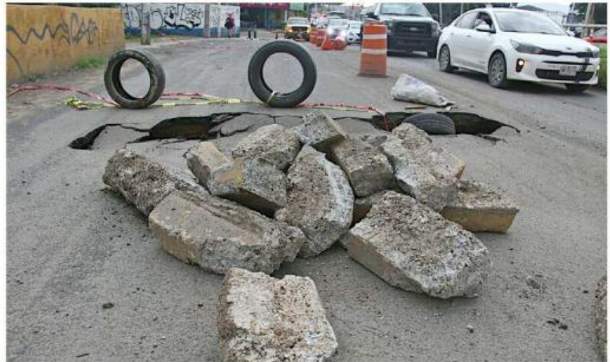
■ El 15 de julio apareció un socavón en Camino Real a Colima, causado por vandalismo.
