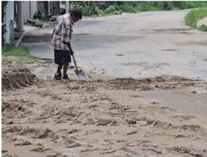
DESPERFECTO. El asfalto y el chapopote de la calle Javier Mina, en la colonia Santa Ana Tepetitlán de Zapopan, fueron levantados por una corriente de agua, tras las lluvias del pasado sábado.
