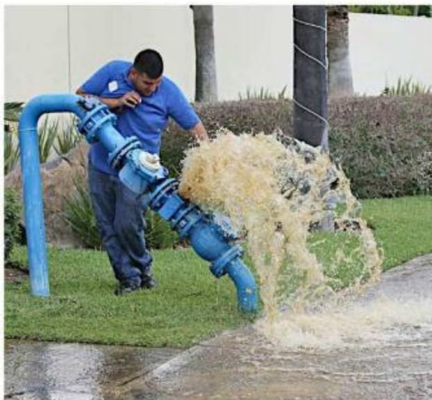
■ La sustitución de la red de distribución ayudaría a detectar tomas clandestinas y fugas.
