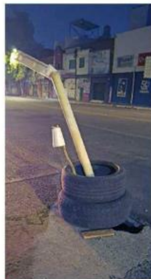
■ Uno de los hoyos está señalizado con tubos y llantas.
