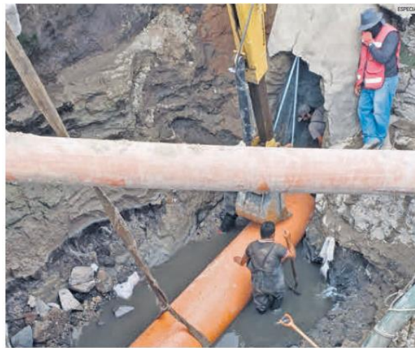
REACTIVACIÓN. El pasado 3 de julio se generó un hoyancho en el cruce de Adolf Horn y 1 de Mayo, en Tlajomulco. Hoy se encuentra abierto a la circulación.
