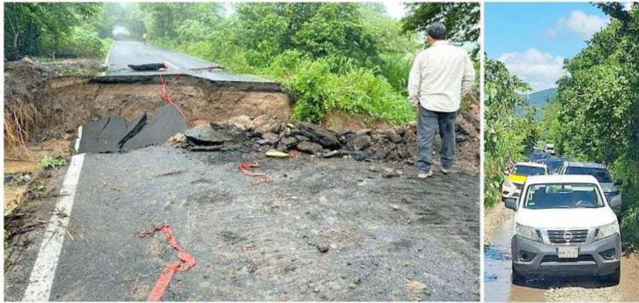
Las lluvias causaron el colapso de la Carretera 80, en Casimiro Castillo; se habilitó una brecha para el tránsito vehicular.
