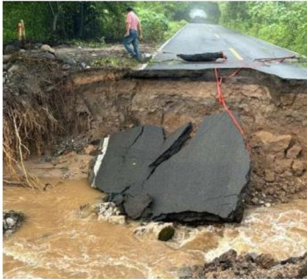
El socavón se generó en el ingreso de El Coyame. ESPECIAL
