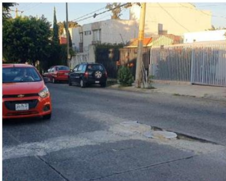
El hundimiento se generó por una obra mal ejecutada. P. NÚÑEZ
