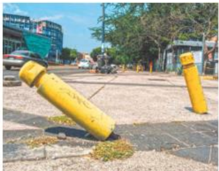
BOLARDOS. Ubicados en Pablo Gutiérrez y Calzada Independencia, están maltratados y torcidos.
