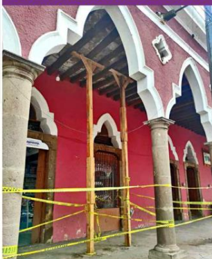
Los arcos están apuntalados, y presentan grietas y desprendimientos.
