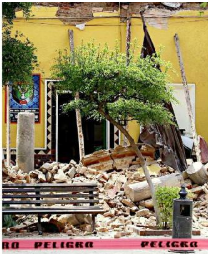
■ Hace dos semanas colapsó una bóveda de este inmueble.
