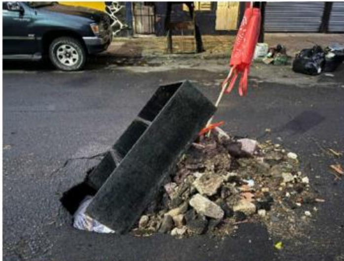
SOCAVÓN. En la colonia Revolución de Guadalajara, un socavón en la calle Pedro Catani y Pensador Mexicano ha generado serias complicaciones en el tránsito desde hace semanas.
