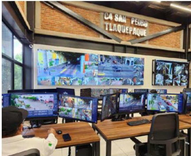
Se instalaron 120 cámaras de videovigilancia en 24 puntos de monitoreo inteligente.
