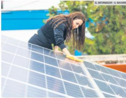
PANELES SOLARES. La adopción de estos sistemas mediante la generación distribuida permite ahorrar energía y cuidar el ambiente.
