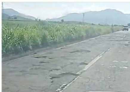
La Carretera 70 está considerada entre las vías que requieren una intervención urgente.
