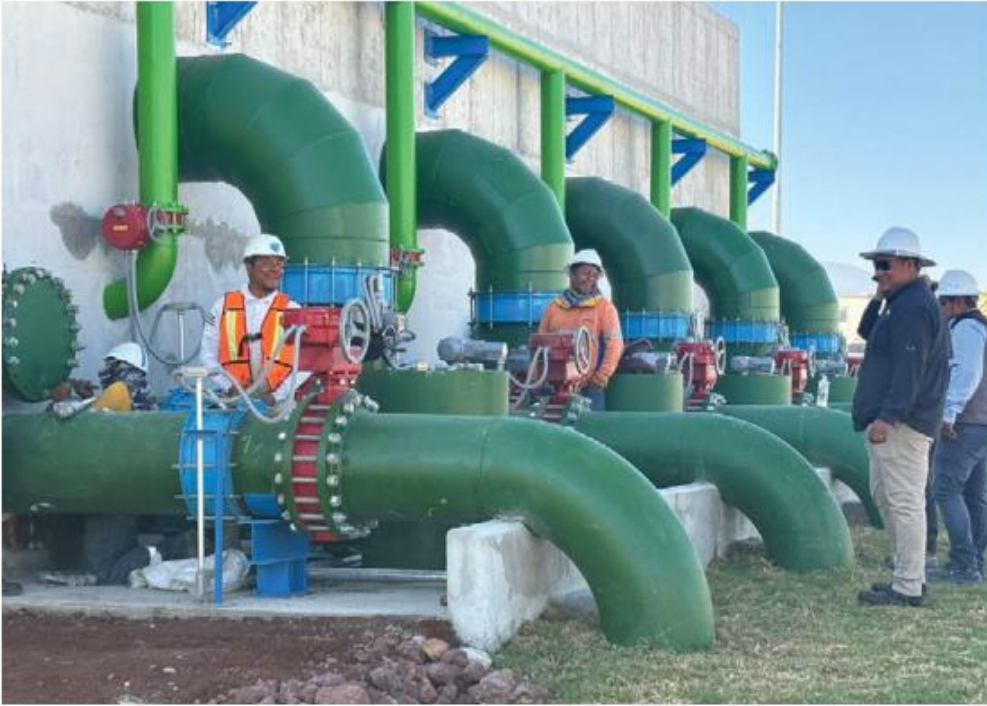
Se invirtieron 850 mdp para mejorar la infraestructura hídrica del estado. ROBERTO HURTADO
