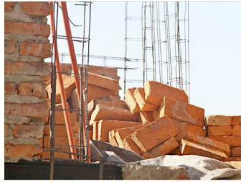
Material de construcción cayó sobre el trabajador.
