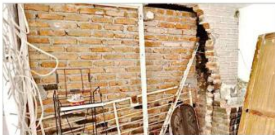
También se apreciaban modificaciones en un muro.
