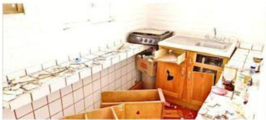
La cocina presentaba daños diversos.
