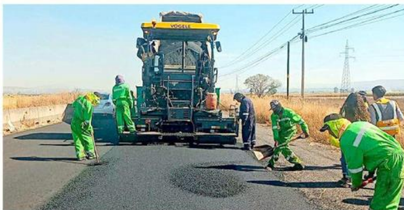
Las obras de conservación rutinaria en carreteras federales ubicadas en Jalisco registran un avance del 50 por ciento.
