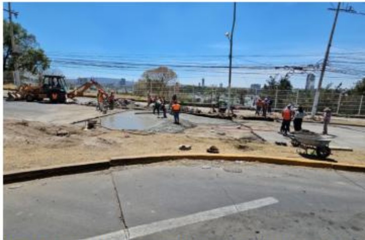
OBRAS. En la avenida Patria, entre Universidad y Madrigal, se produjo un socavón de grandes dimensiones que irrumpió el tránsito unas horas. Trabajadores se encargaron de reparar el daño.
