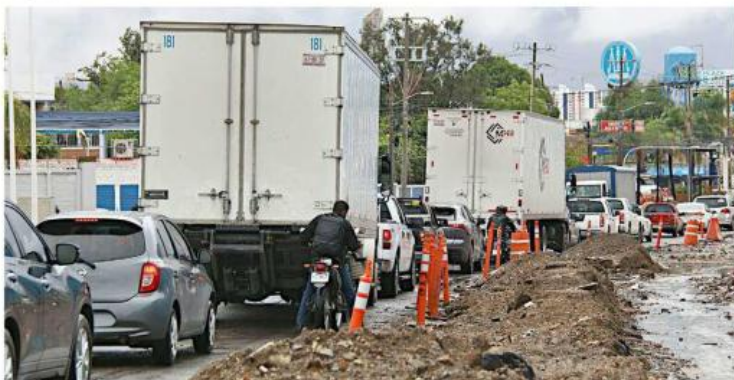
Debido a la lluvia y a los trabajos que se realizan, Camino Real a Colima fue prácticamente intransitable.
