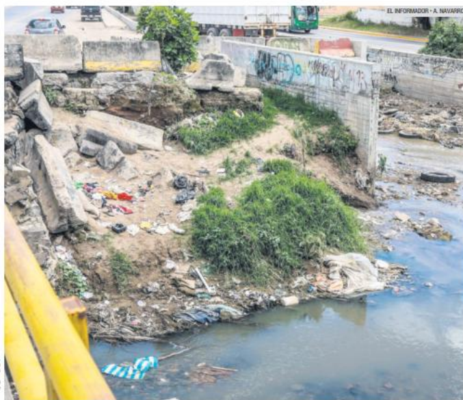
ARROYO DE OSORIO. La última tormenta provocó que este canal se desbordara y destruyera una parte importante del Parque Luis Quintanar (ubicado en los límites de Tonalá y Guadalajara).
