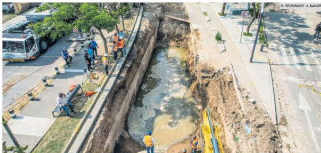
TEMOR. Vecinos exigen revisar toda la avenida Malecón, ante el temor de nuevos hundimientos por fallas ocultas.
