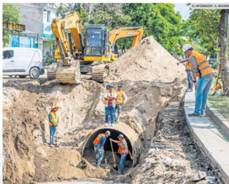
RIESGO. Un socavón de más de 20 metros de largo se abrió en Avenida Malecón; vecinos exigen revisar toda la infraestructura pluvial de la zona.
