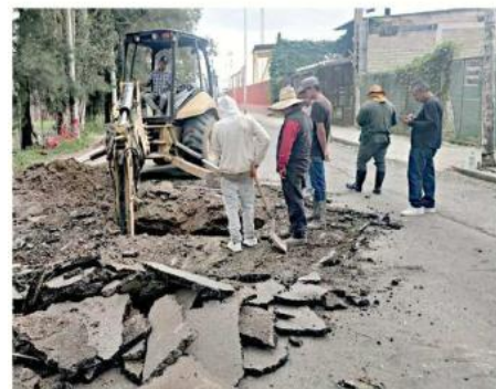
■ El socavón surgió el martes.
