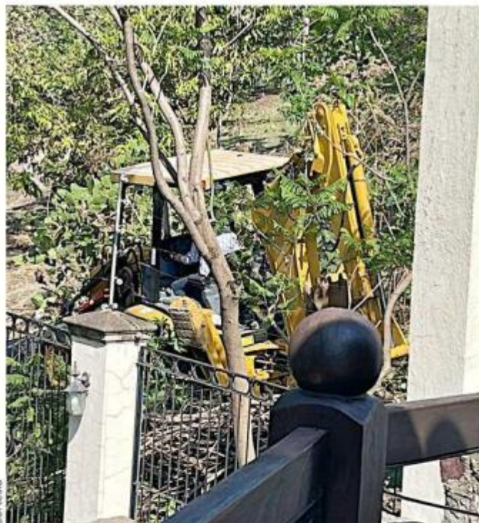
Los vecinos aseguran que hay movimiento de tierra con maquinaria desde julio.
