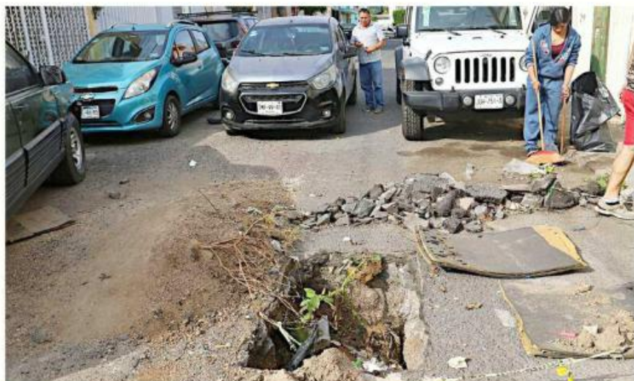
■ El socavón ubicado en la Calle Fernando Espinoza, entre Artes y Federico Medrano, está próximo a cumplir un año, según vecinos.
