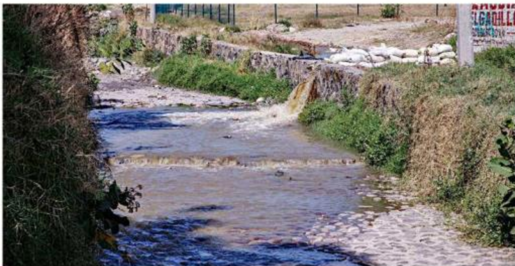
La fuga se registra en una alcantarilla ubicada sobre la Avenida Mateo de Regil. El agua se derrama en el canal que corre en paralelo a esta vía.
