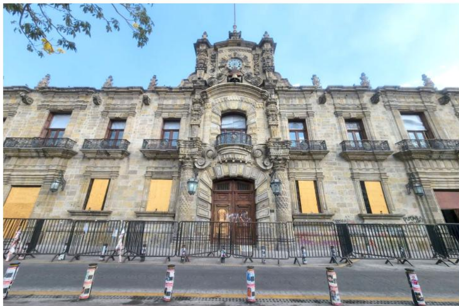
Palacio de Gobierno todavía muestra daños de la manifestación de noviembre.
