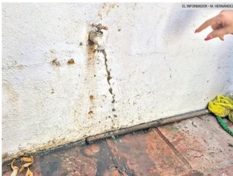
DEFICIENCIAS. Agua turbia y con olor a drenaje brota de la llave en las viviendas de la ciudad, reflejando fallas en el sistema.
