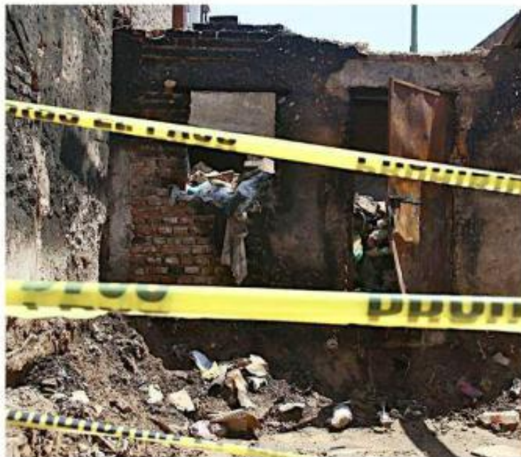
■ El techo de asbesto y láminas colapsó.
