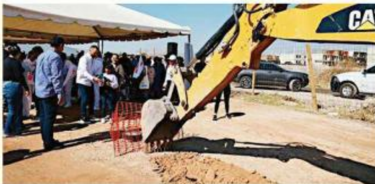
El pozo será parte de la red hídrica de la Avenida Adolf Horn.
