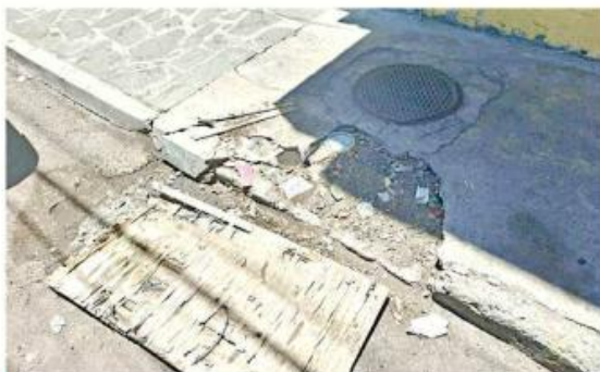
En la Calle Secundina Gallo, casi a su cruce con Gómez Orozco está la banqueta fracturada y hay un desagüe tapado con un tablón.
