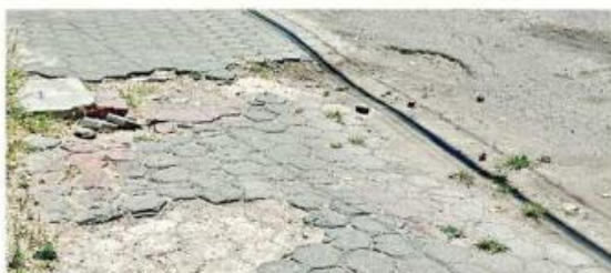
En la Calle Fernando Espinoza hay una banqueta también en mal estado.
