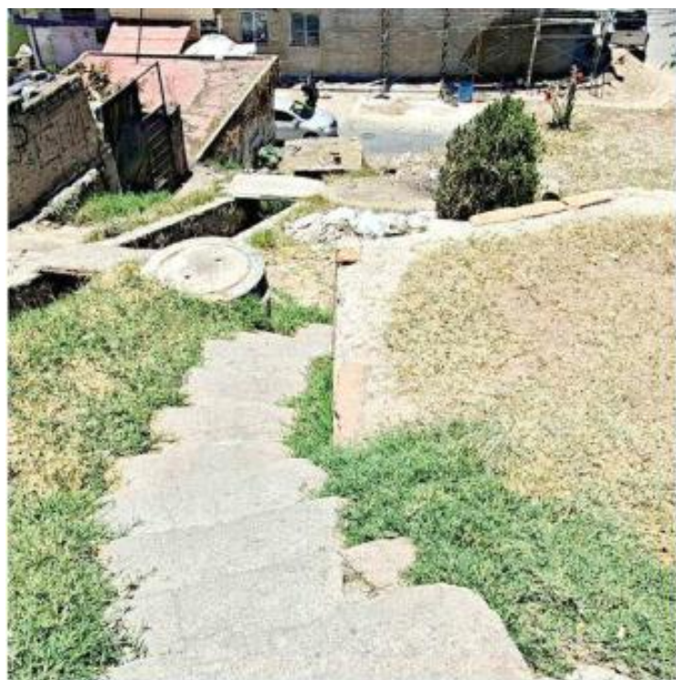
Una de las escaleras tiene escalones irregulares y rotos. Peatones tienen que dar grandes zancadas en algunos tramos.
