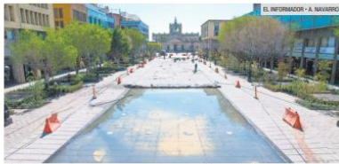
DETALLE. La obra busca recuperar el espacio público y priorizar al peatón.
