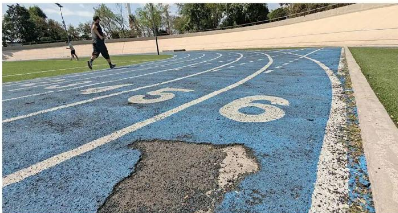
El tartán de la pista de atletismo presenta desgaste visible en varios tramos.
